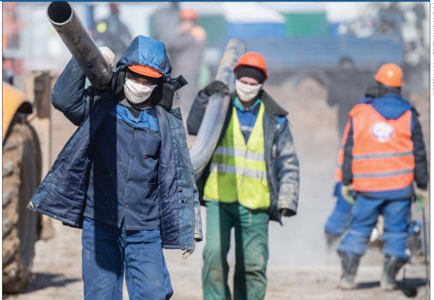
Рабочие на строительстве инфекционной больницы для приема пациентов с коронавирусом в поселении Вороновское в Новой Москве
